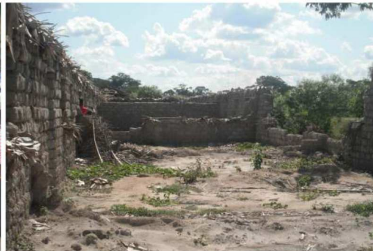
Ecole du village Mbiza Danze, construction abandonnée, destruction par les fortes pluies
