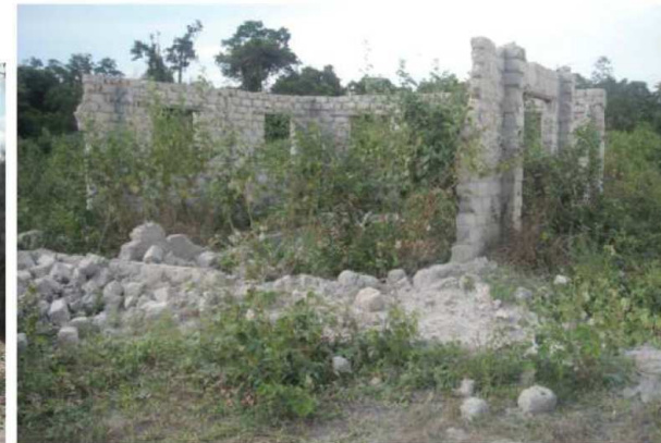
Centre de santé du village Isoko en destruction suite à l'abandon des travaux de construction
